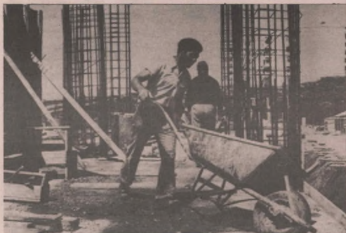
É na construção civil que mais se sente o flagelo do desemprego, e que até agora não viu qualquer solução por parte do Governo
